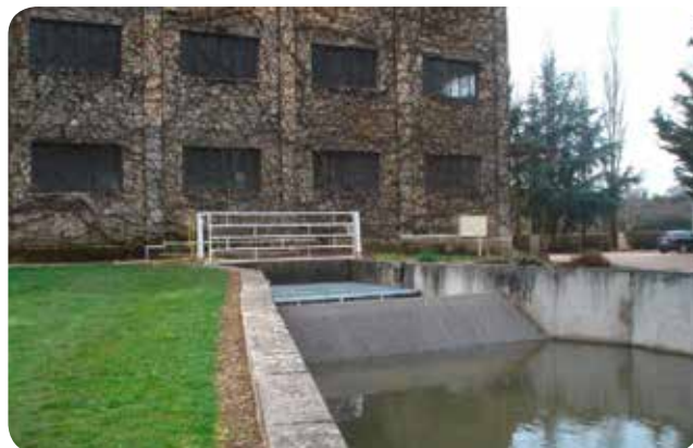
➤ Vue de la prise d'eau rénoverée et ichtyocompatible avec la grille inclinée
