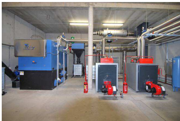
Chaudière bois (à gauche) et chaudières fuel d'appoint (à droite)
