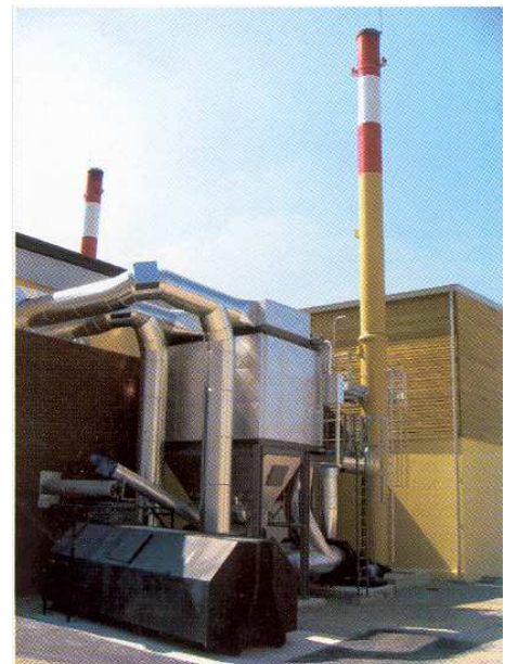
Vue extérieure de la chaufferie bois
